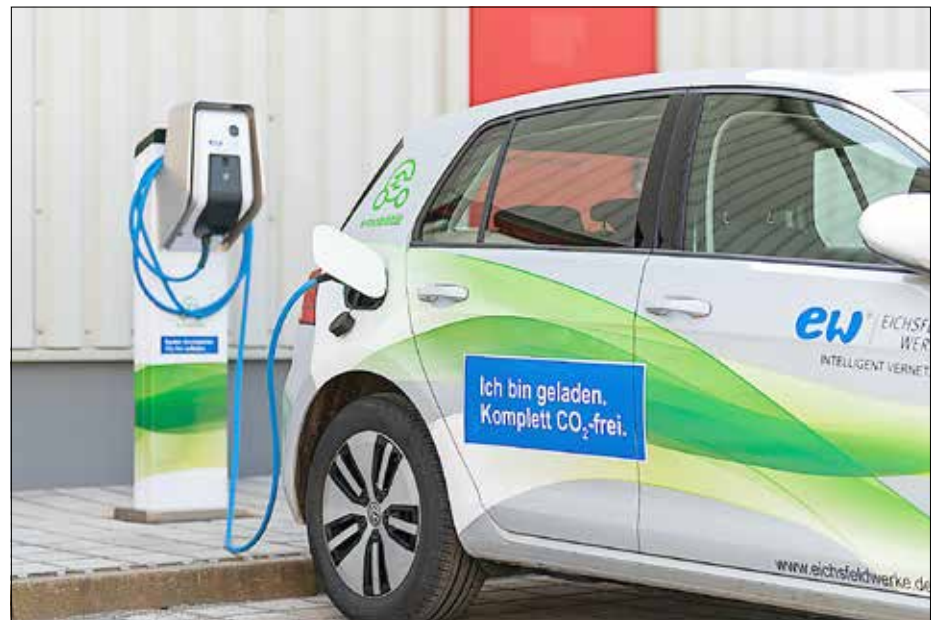
Mehr Power auf dem Betriebsgelände - Eichsfeldwerke bauen E-Ladenetz weiter aus.
